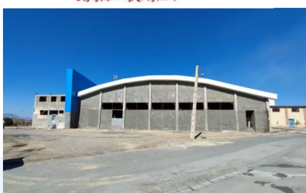
ادامه احداث ساختمان استخر شامل (اجرای وال پست، سفال چینی و نصب ساندویچ پانل)
