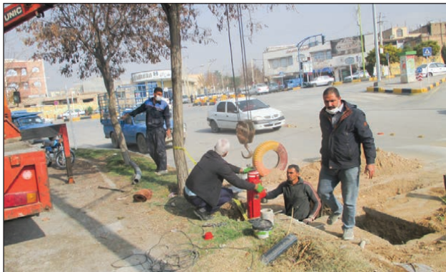
نصب ۱۰ شیر هیدرانت آتش نشانی در نقاط مختلف سطح شهر
