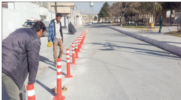
اجرای اصلاح هندسی تقاطع خیابان امام با خیابانهای آزادی و هفده شهریور
